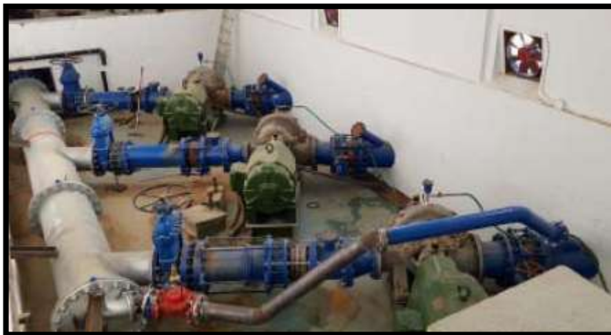
Equipos de rebombeo Palmeral
