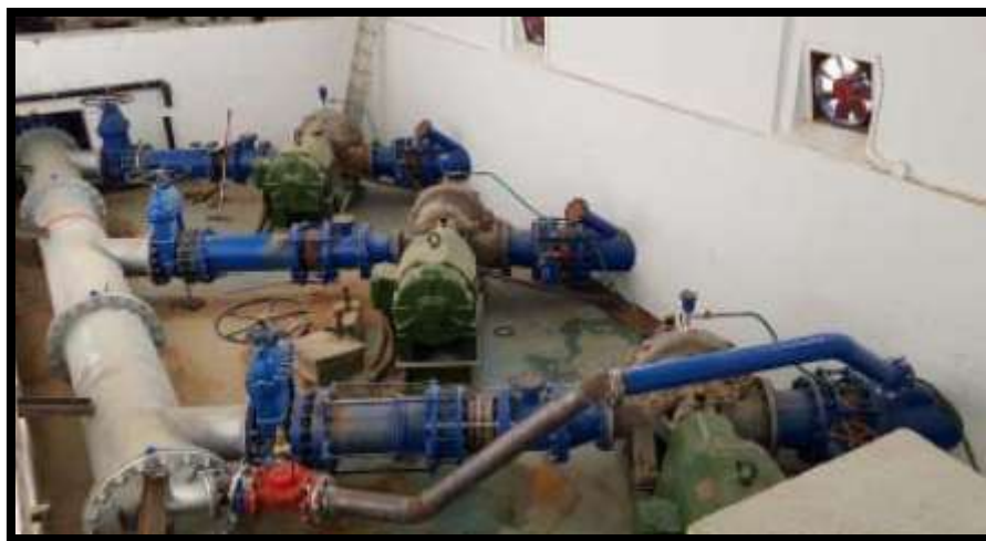
Equipos de bombeo Palmeral
